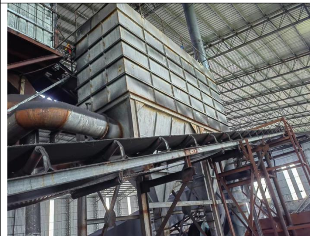
干燥冷却布袋除尘器
