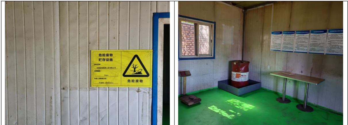
危废暂存间照片
