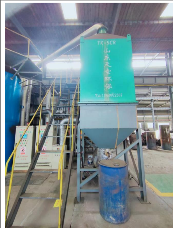
2#50t 备用天然气加热炉 SCR 脱硝设施
