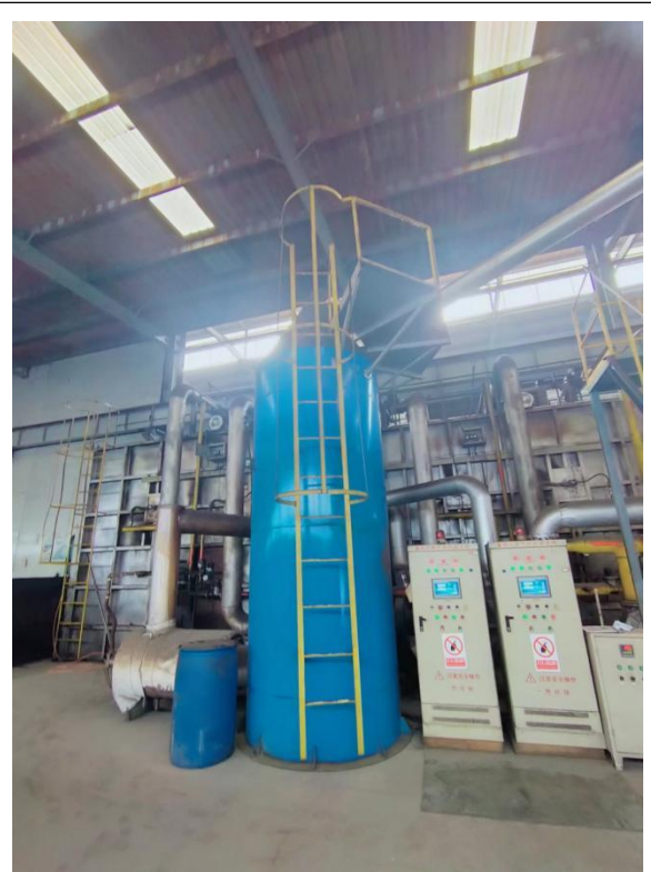
1#50t 天然气加热炉 SCR 脱硝设施
