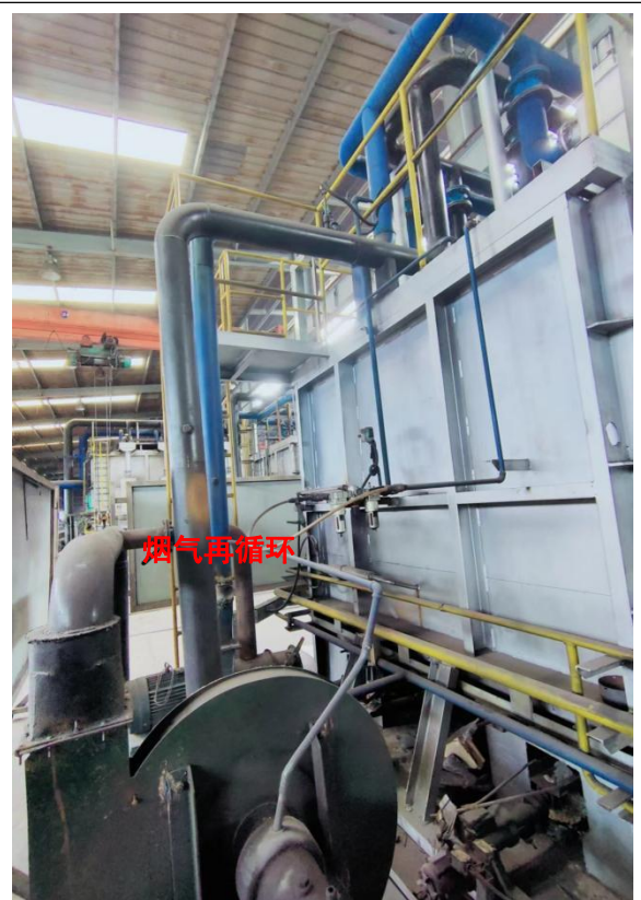
5#5t 备用天然气加热炉低氮燃烧装置 (低氮燃烧器+烟气再循环)
