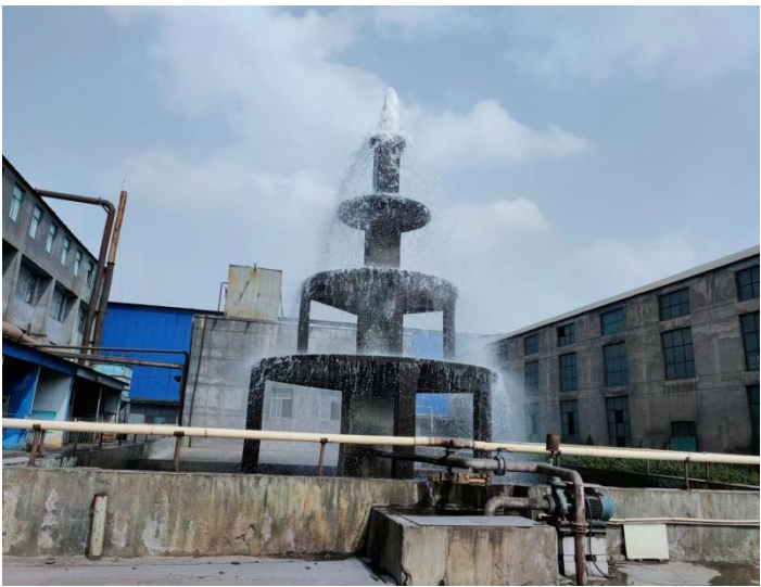
冷却循环水池
