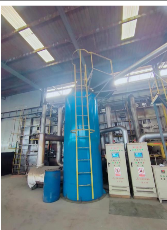
1#50t 天然气加热炉 SCR 脱硝设施
