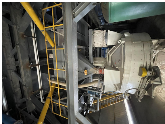
搅拌废气收集系统
