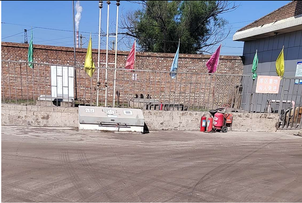
三次油气回收设备
