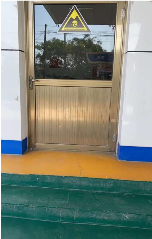
项目建成的危废间
