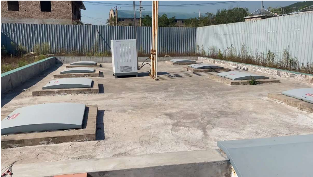
三次油气回收设备
