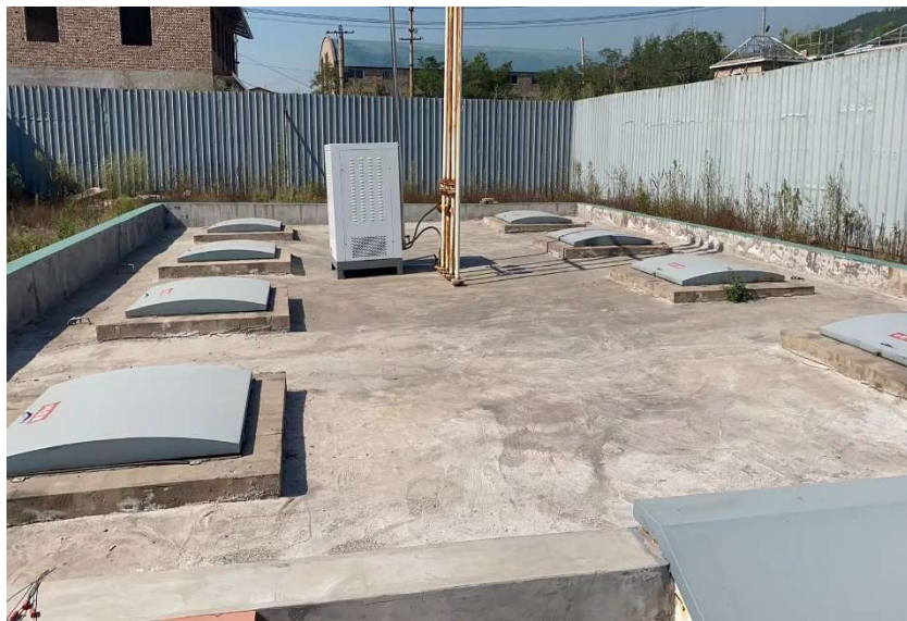
储油罐区及油气处理设施
