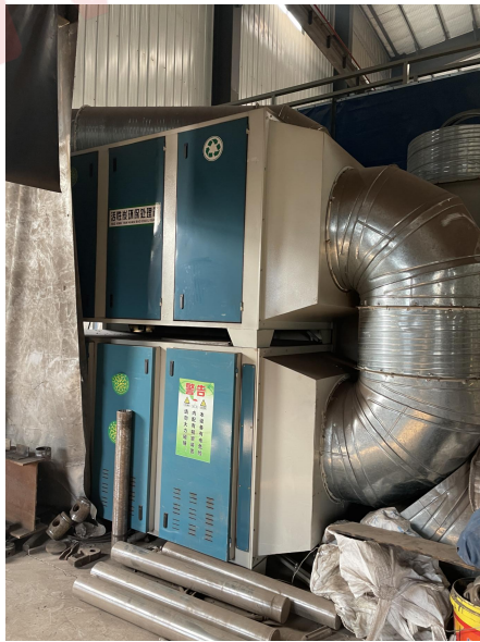
过滤棉+活性炭吸附处理装置
