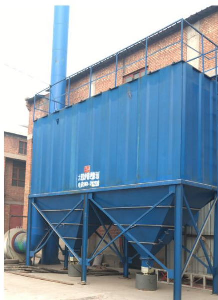
中频炉、浇铸、落砂除尘器
